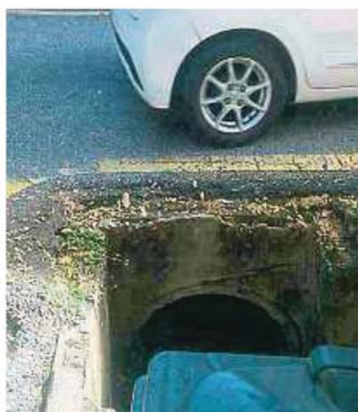
沟渠没有沟盖，威胁道路使用者安危。
